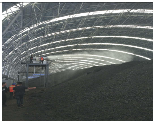
储煤场内喷雾洒水喷枪
