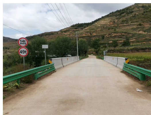
桥梁路面现状
