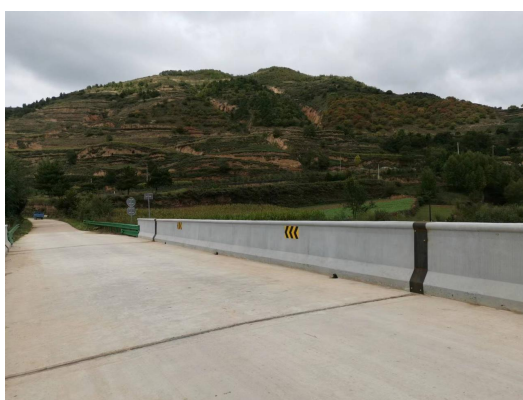
桥面径流收集口
