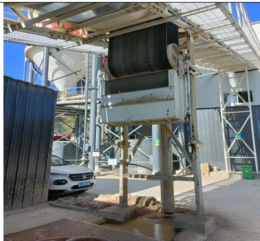
皮带清洗及沉淀池
