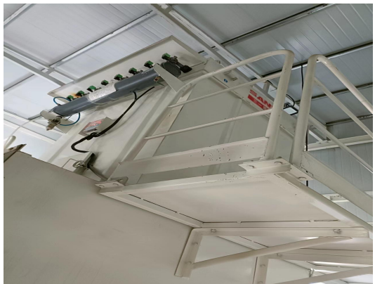
拌合系统脉冲除尘器
