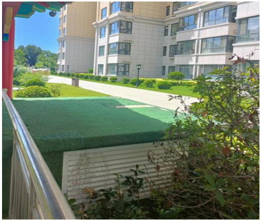
车库尾气排口
