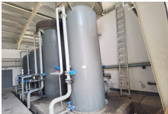
生物活性炭塔
