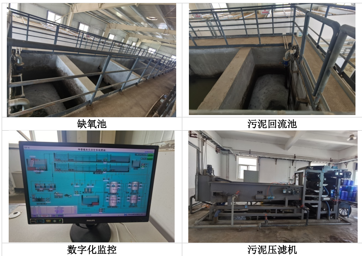
图 5.2.1-1 生活污水处理站主要设施设备照片
